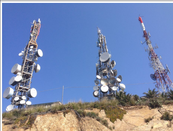
Vista di assieme tralicci A, B e C
