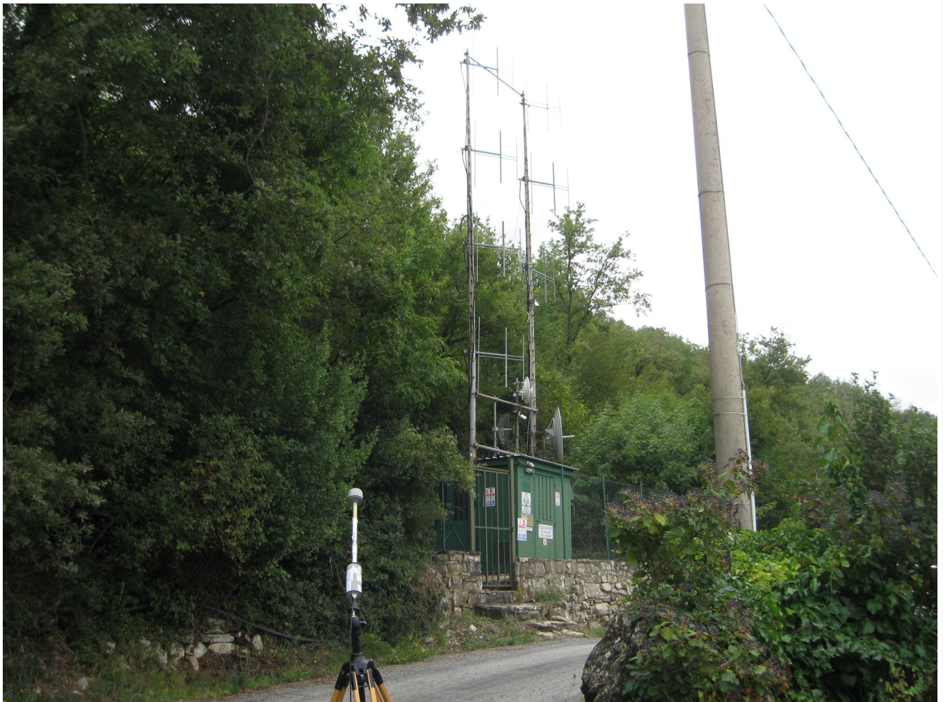
Vista dell'impianto dal punto di misura P3
