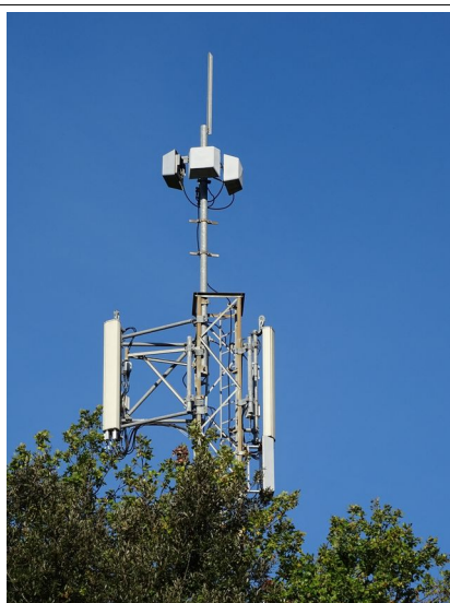
impianti RaiWay e WindTre
