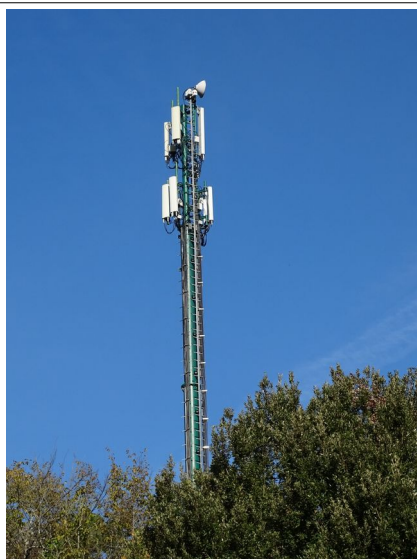
impianti Tim e Vodafone
